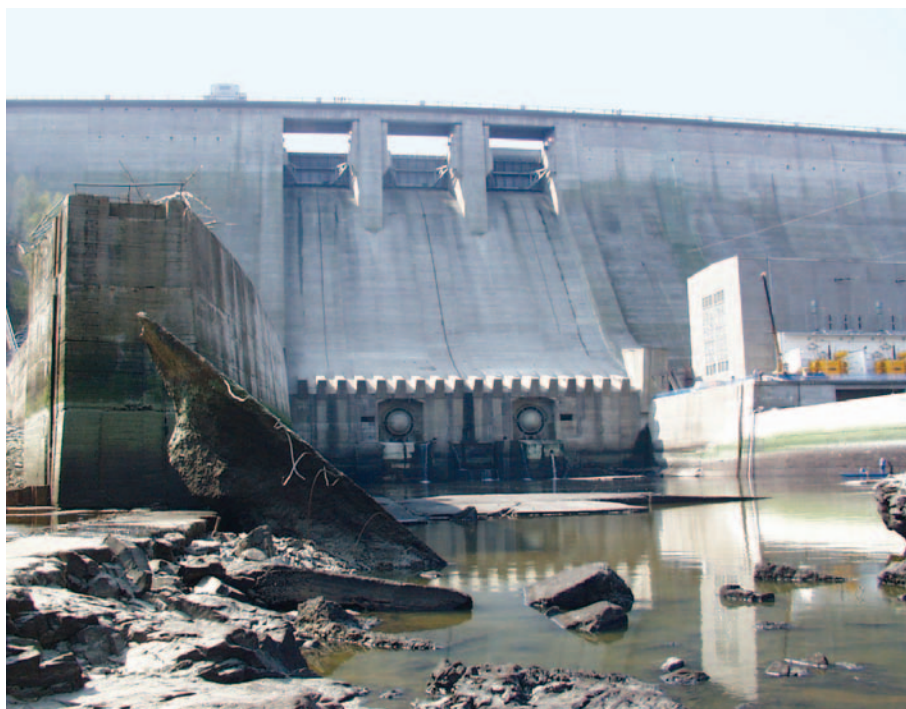
Obr. 5.7. Vývar VD Orlík poškozený povodní
