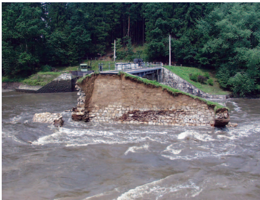
Obr. 5.10. Protržená hráz nádrže Soběnov (Hradiště) na Černé
